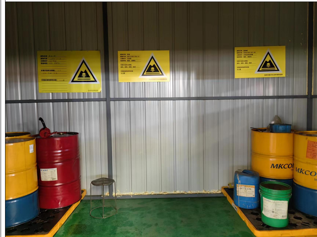
地面防渗、分区标识、防渗漏托盘
